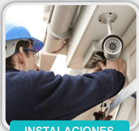
INSTALACIONES DE CÁMARAS DE SEGURIDAD
